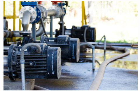
Bombas de presión para el lavado del filtro.
