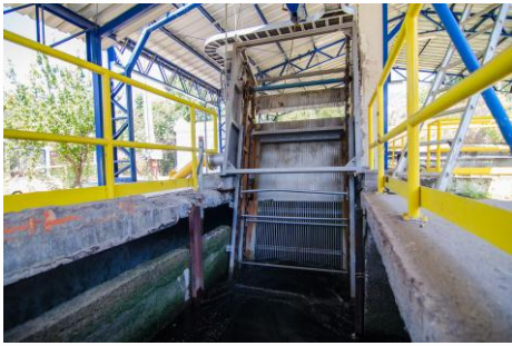
Vista de la reja automática de desbaste.
