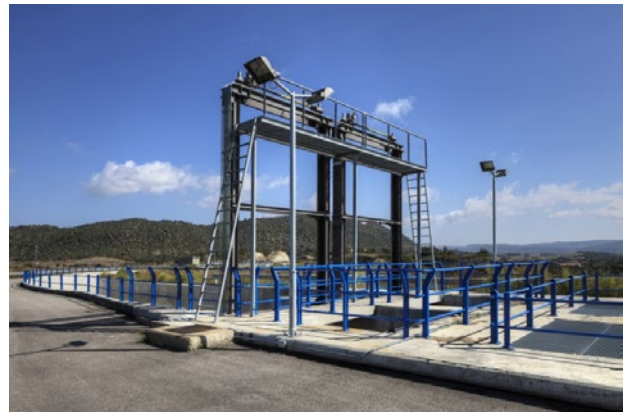
Compuerta Canal Vagón CMW
